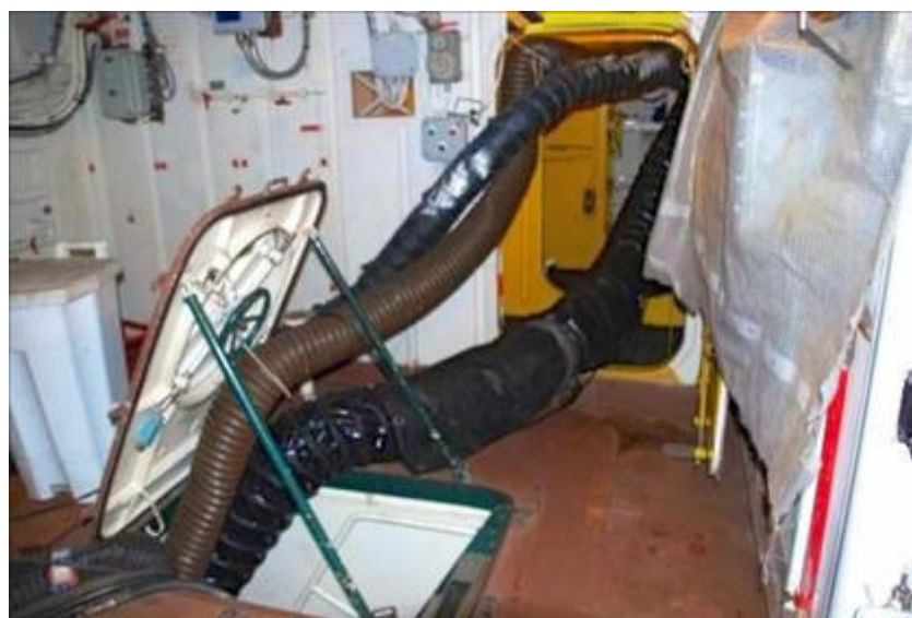
Coursive obstruée de navire en arrêt technique
