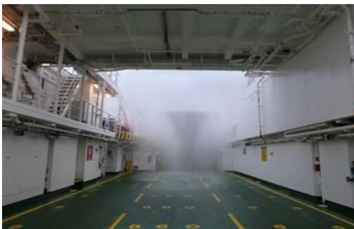
Drencher en eau sur pont garage
